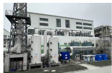
廃棄ガス処理スクラバーと MBR 水処理施設による環境対応
