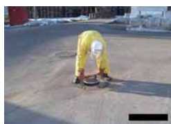
雨水管への流れ込みを防ぐため の下水道ポップアップ訓練 (Durez Canada)
