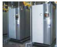
ガスボイラー
