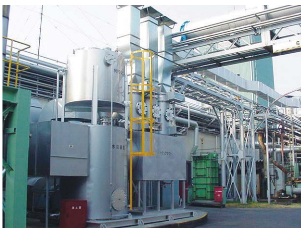
排ガス処理装置
