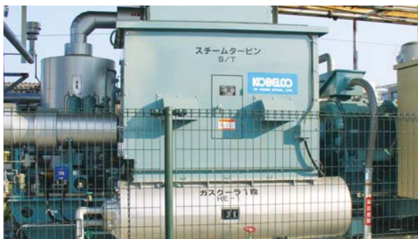
スチームタービンコンプレッサー(静岡工場)
