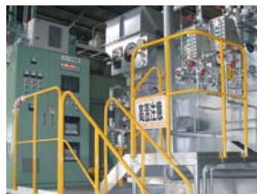
燃料転換したボイラー (尼崎工場)
