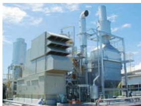
コージェネレーションシステム (静岡工場)
