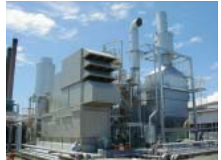
コージェネレーションシステム(静岡工場)
