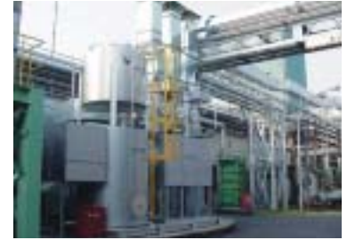
排ガス処理装置
