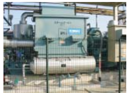
スチームタービンコンプレッサー(静岡工場)
