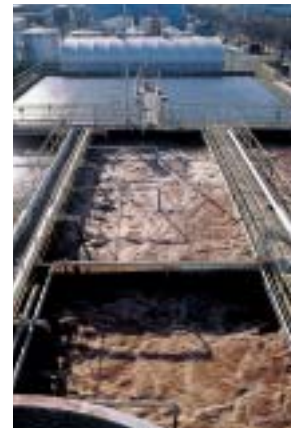
活性汚泥処理装置 (静岡工場)
