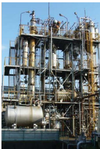
高精度フェノール回収装置(静岡工場)
