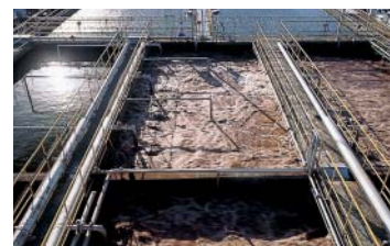
活性汚泥処理装置(静岡工場)
