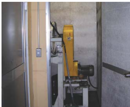
作業場の騒音防止対策 (静岡工場)
