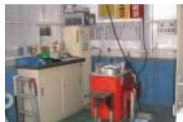
廃アセトン蒸留・再生装置
