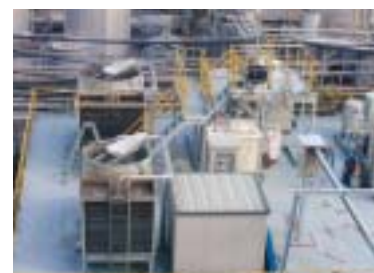
工場排水循環装置(尼崎工場)
