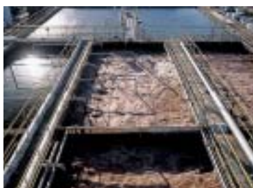
活性汚泥処理装置(静岡工場)
