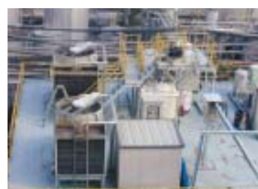
工場用水循環装置(尼崎工場)
