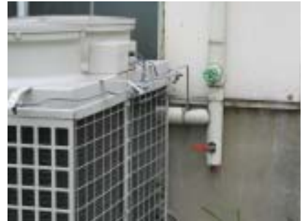
エアコン室外機の水冷化 エアコン室外機を水冷化して冷媒ガス圧力上昇を抑制することにより電力使用量を削減しました。(津工場)
