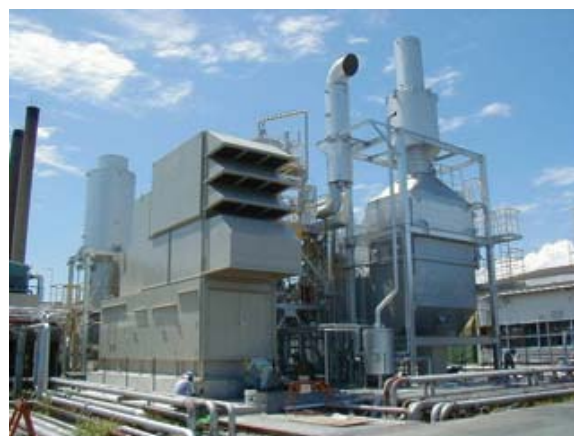
コージェネレーションシステム(静岡工場)
