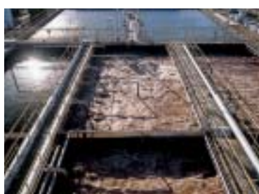
活性汚泥処理装置(静岡工場)
