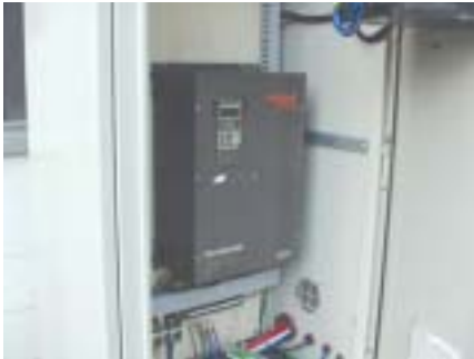
排ガス燃焼装置プロセスガスファンのインバーター制御 塗布機排ガス処理装置において排ガス量に追従した処理流量調整で電力使用量および燃料を削減しました。(静岡工場)
