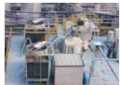
工場用水循環装置（尼崎工場）
