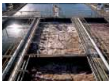
活性汚泥処理装置（静岡工場）
