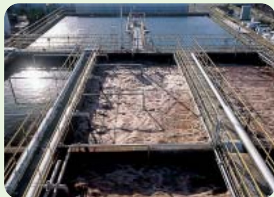
活性汚泥処理装置
